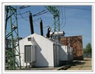
Transformátor 400 kV/110 kV
